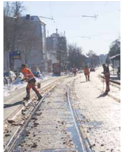
Schwer malochen mussten viele Dutzend Bauarbeiter, um die Gleise wie hier an der Weserspitze von Schnee und Eis zu befreien (Foto BS)
